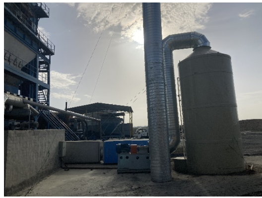
静电捕集+纤维滤料吸附+水浴除尘设备
